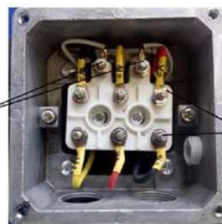
Клеммная колодка двигателя с термистором обмотка двигателя
